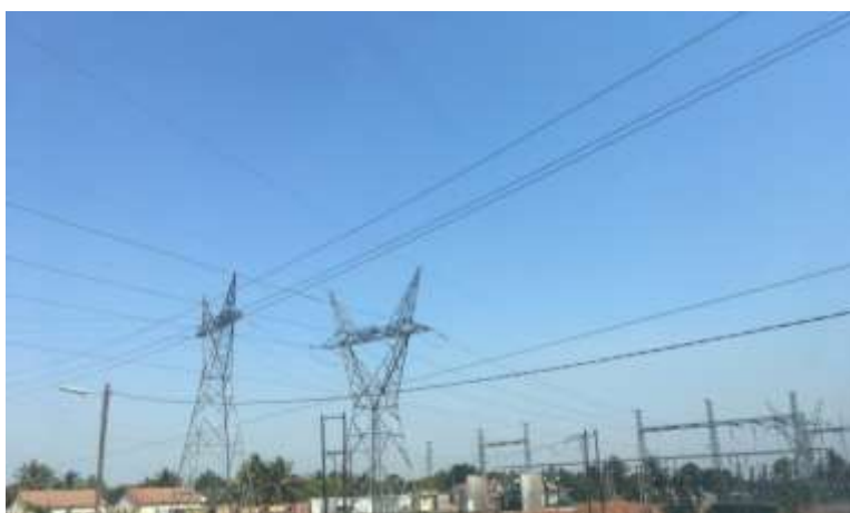
Fotografia 6.6 – Subestação no Município de Macia
