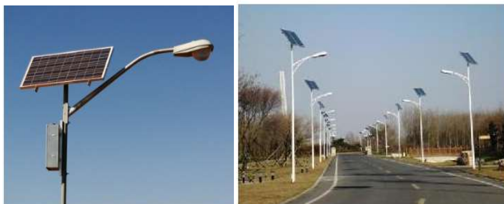
Figura 8.13 – Iluminação pública através de painéis solares
